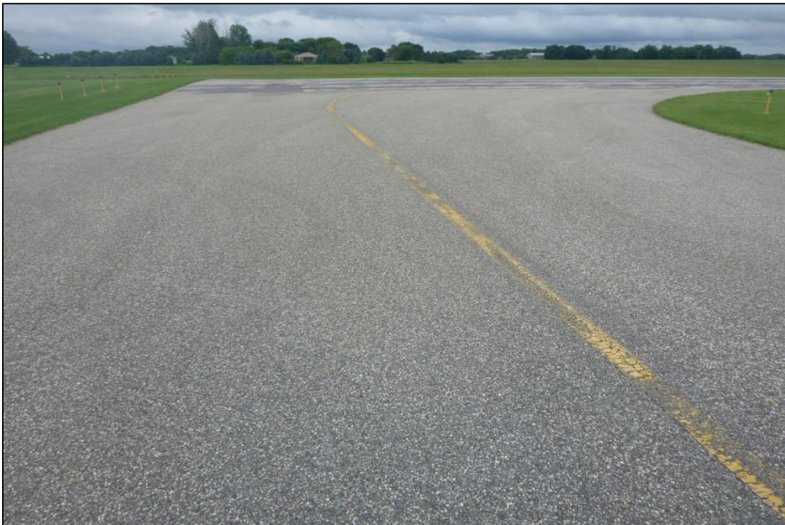
CFE PTA 001 (PCI = 86)
