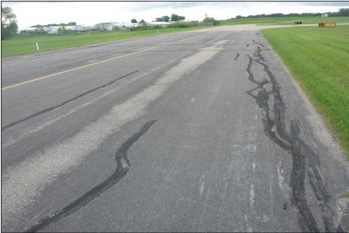
CFE PTA 002 (PCI = 62)
