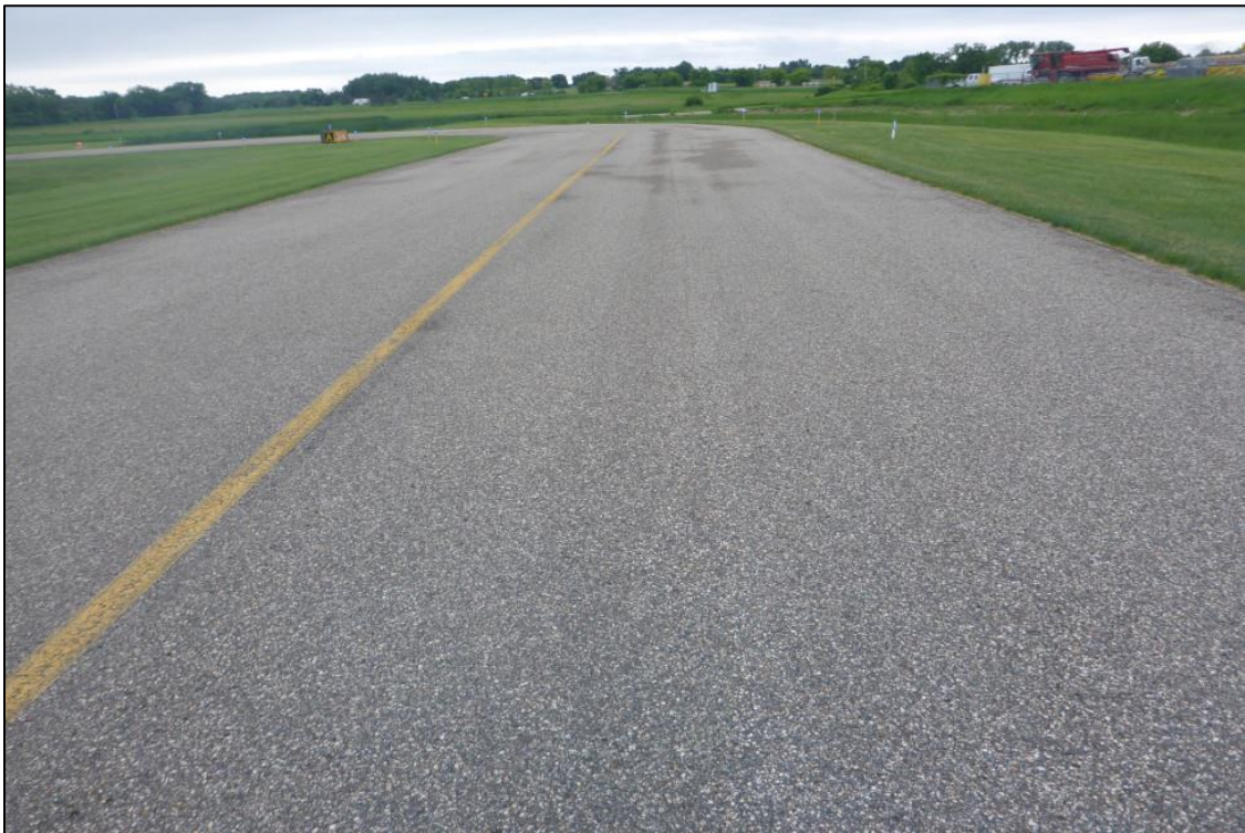
CFE PTA 003 (PCI = 88)
